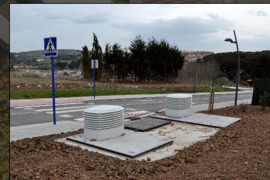
Posto de Transformação
